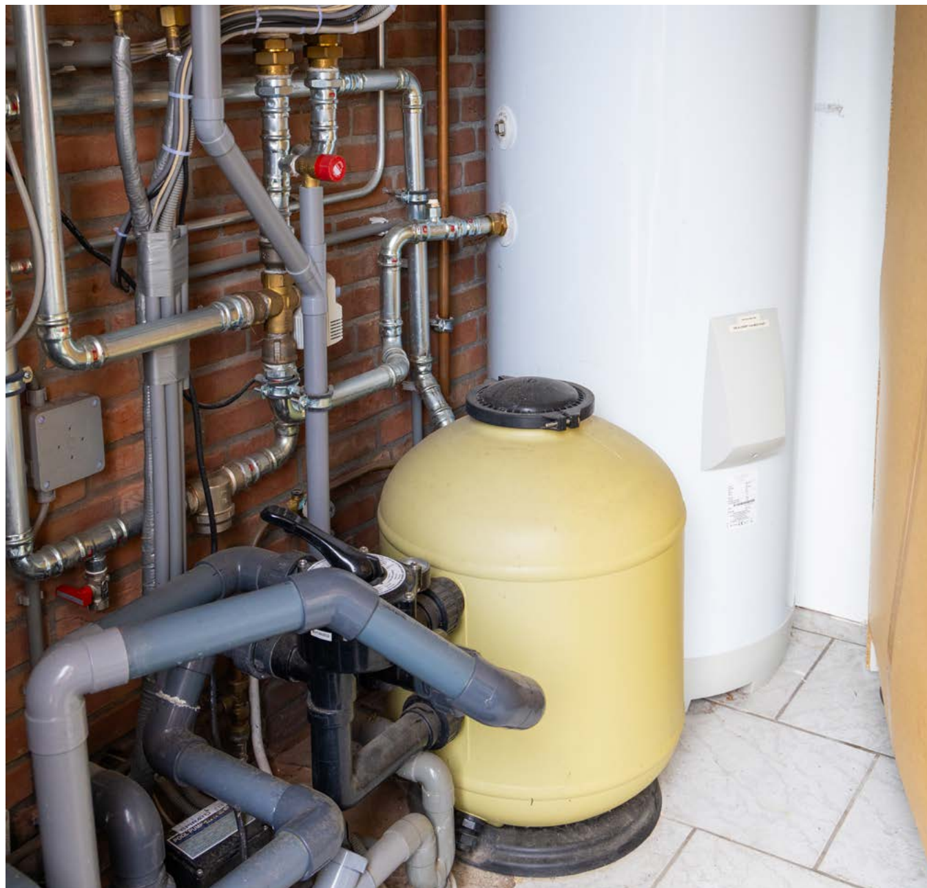
Binnenunit warmtepomp met boiler en voorraadvat
